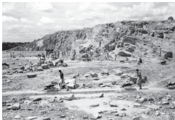
Construção do açude Ingazeira perto da cidade de Paulistana, PI. Acervo IBGE.
